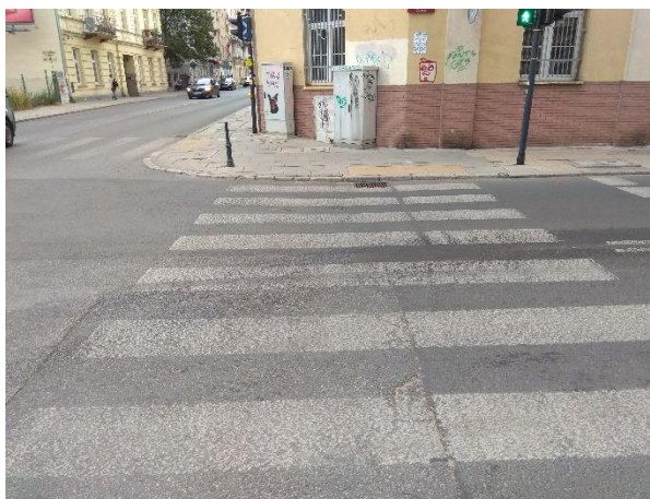
Zdjęcie 11. Krawężnik przy przejściu dla pieszych przez ul. Żwirki [10 lipca 2018 r.].
